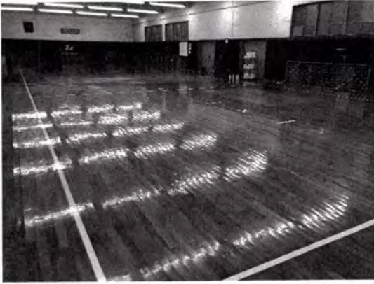
写真2. FBシステムを設置した剣道場
